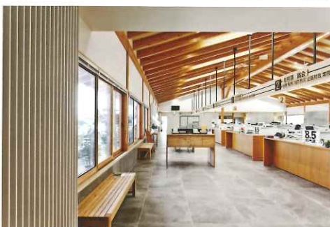
朝日村役場 (地中熱利用空調設備を執務室に設置)
